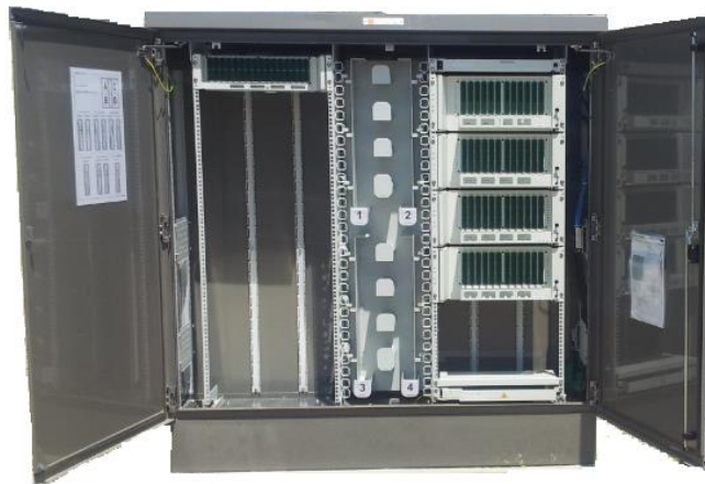
Exemple d'un PM, 360 locaux desservis, 576 fibres distribuées
