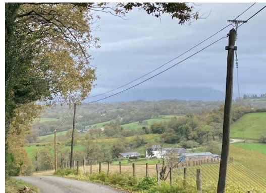
Réseau fibre optique sur appuis Orange (câble sur réhausse)
